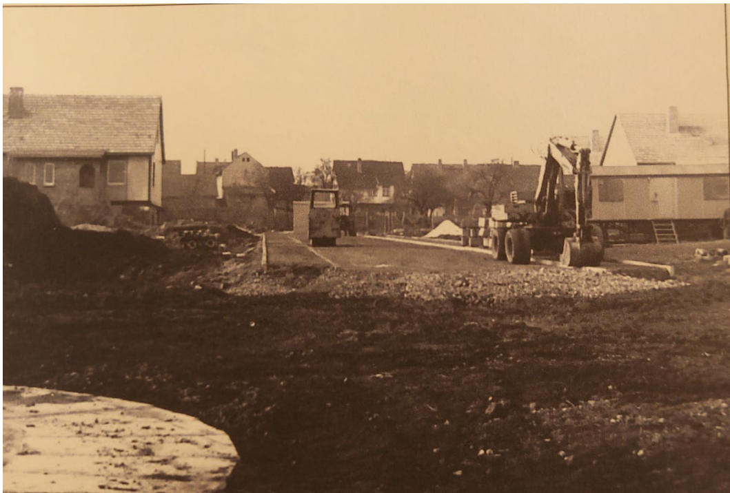
Zügig wird auch schon an der Befestigung der Straße gearbeitet. Im Vordergrund links die Klärgrube.
