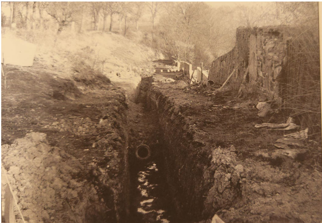
Der Überlauf von der Klärgrube führt unter der Liete entlang.
